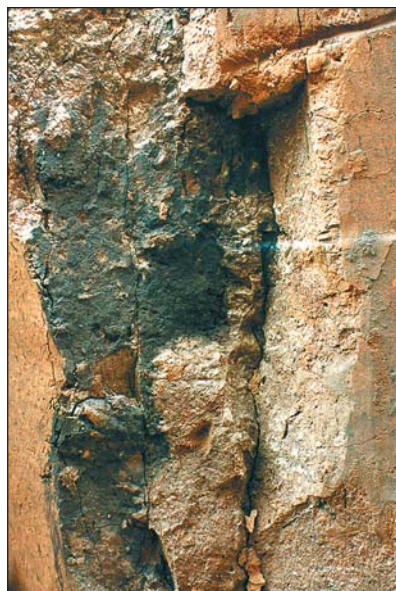
Крупная трещина, по поверхности которой видны темные потеки органического вещества.
